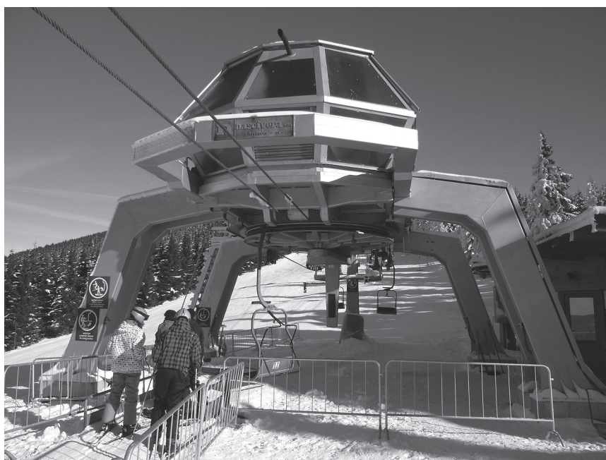
Údolná poháňacia a napínacia stanica presunutej 2-miestnej sedačky Čerňava – Šerák na Ramzovej
