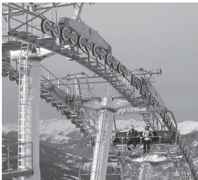
■ Zoskupenie traťových podpier s kladkovými batériami pred vrcholovou stanicou TSD-6 Les Arcs
