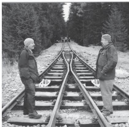
■ Pri rekonštruovanej výhybke pozemnej lanovky šéfmanažér firmy Garaventa Nikolaus Moser (vľavo) a šéfmontér Marcel Julier (vpravo)
