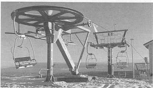
■ Vratná stanica lanovky TS2
